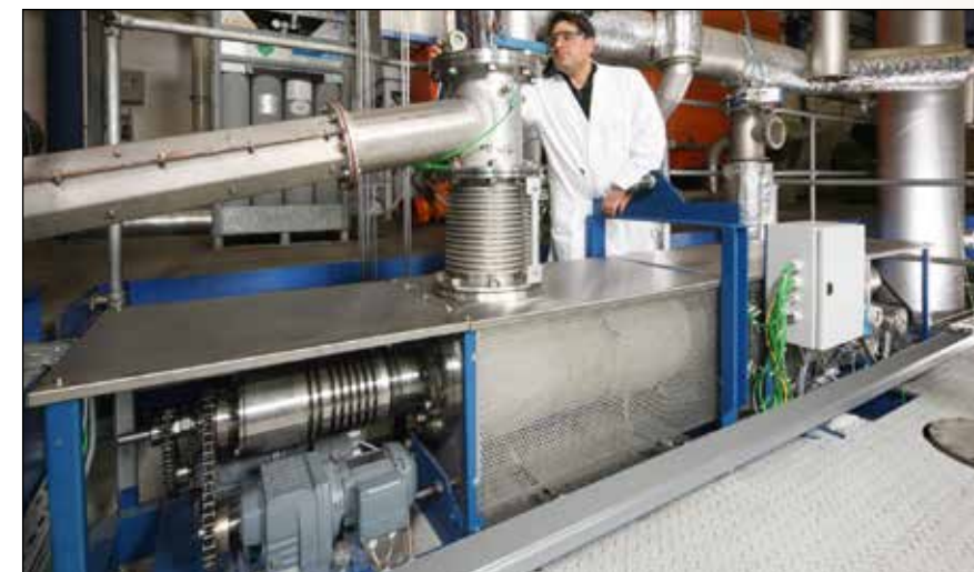
Proefopstelling van een TCR-installatie
